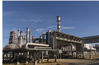
(d) Pipes of a petrochemical plant.
